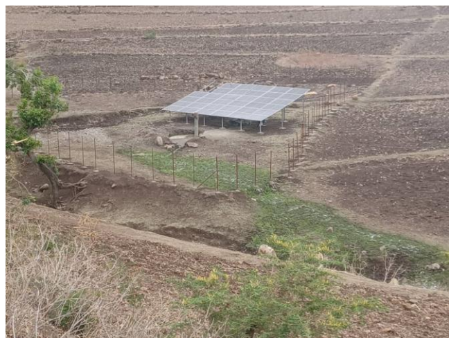
Panneaux solaires vu de la colline du réservoir
