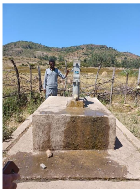
Pompe à main provisoire
